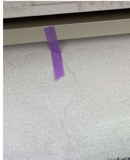
基礎巾木のヘアークラック
