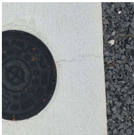
土間コンクリート ヘアークラック
